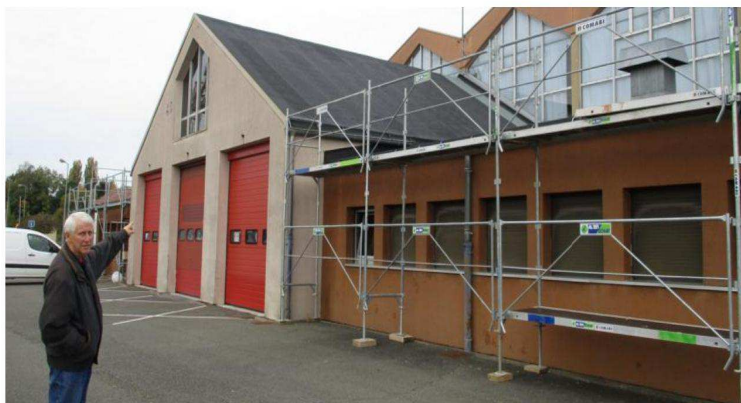
Christian Chevry, adjoint aux travaux, devant les travaux réalisés sur la toiture.
